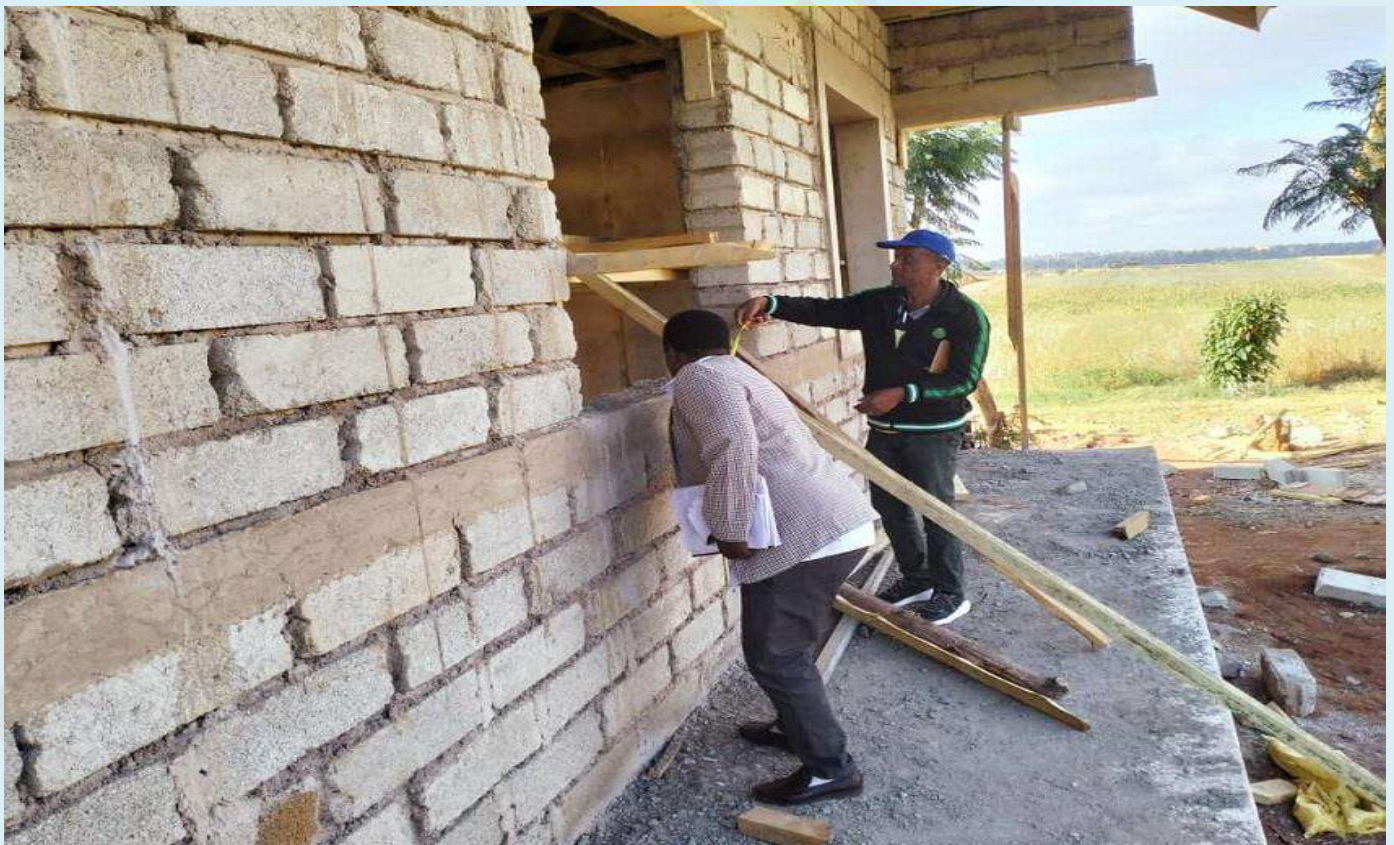
Mwenyekiti wa Halmashauri ya Wilaya ya Siha Mhe. Duncan Urassa (kulia) akiwa na Mhandisi wa Ujenzi Halmashauri ya Siha Sospeter John wakikagua ujenzi wa madarasa katika shule ya Msingi Lemosho Kata ya Ndumeti
